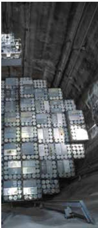
Olkiluodon voimalaitosjätteen loppusijoitus-tilan (VLJ) MAJ-siilon säteilysuojat. Taustalla näkyvät jätepakkausten kuljetuslavetti ja nosturi. (Kuva:TVO)
